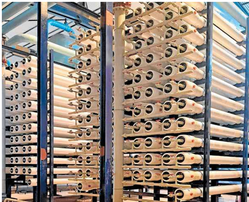
Imagen de los nuevos bastidores y membranas de la desaladora de Marbella. SUR
